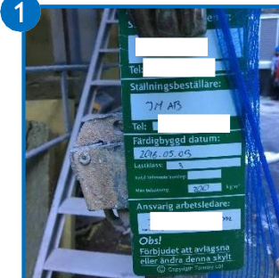
Dokumentation av besiktigad ställning ska anslås vid samtliga tillträdesleder till ställningen på markplan och takplan, innan ställningen tas i bruk.
